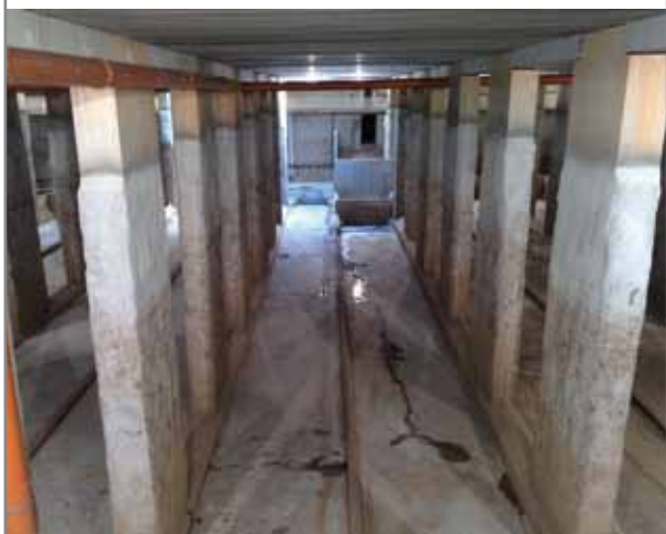
Figura 6. Ejemplo de tanque de tormentas de la Estrella en Badalona.
