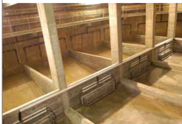
Figura 3. Ejemplo de tanque con sistema de limpieza automático.
