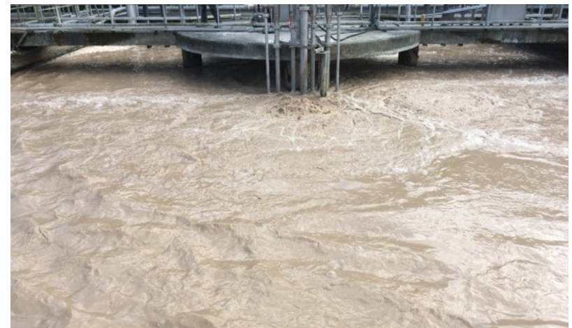
Vista de la agitación producida por los equipos Jet Blower en el agua residual
