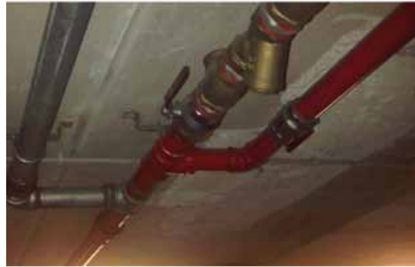
FIGURA 12. Derivación de agua desde la red de incendios.
