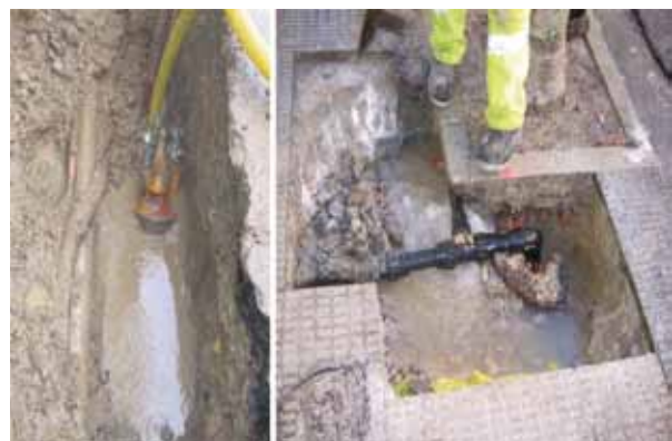
FIGURA 13. Afecciones por raíces.
