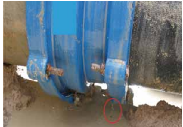
FIGURA 5. Fuga de goteo por mal ajuste en el montaje de obra.
