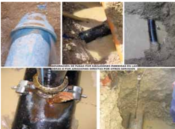
FIGURA 8. Afecciones por deficiencias constructivas.
