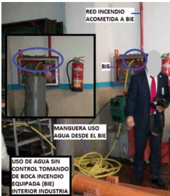
FIGURA 11. Uso de agua sin control desde BIE.
