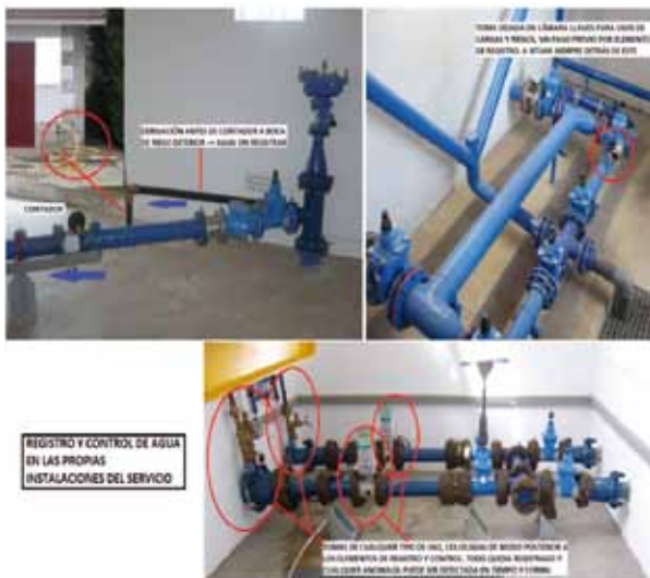
FIGURA 7. Registro y control de agua en instalaciones.
