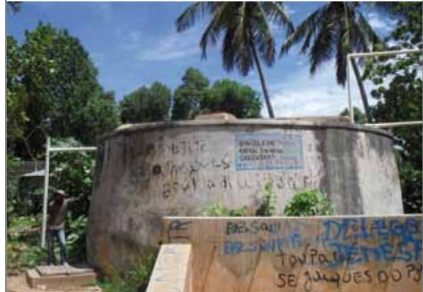
Depósito de agua en una localidad al norte de Haití. Imagen cedida por Waser Ingeniería del Agua.
