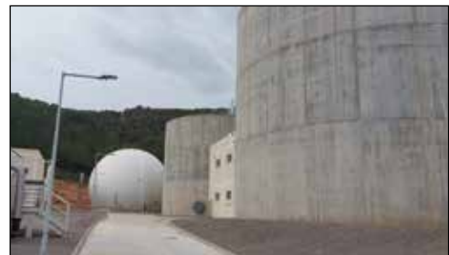
Tratamiento de fangos.
