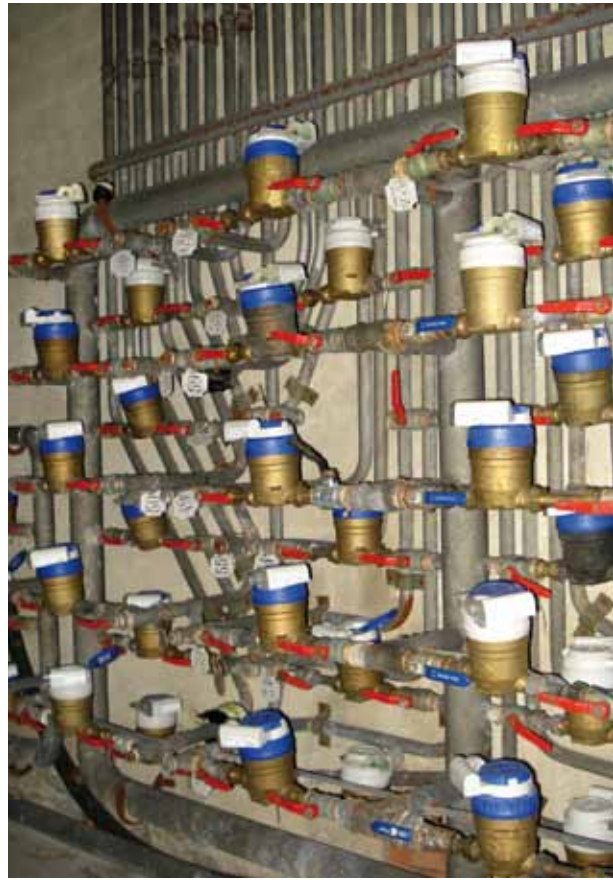
Batería de contadores mecánicos con telelectura.
