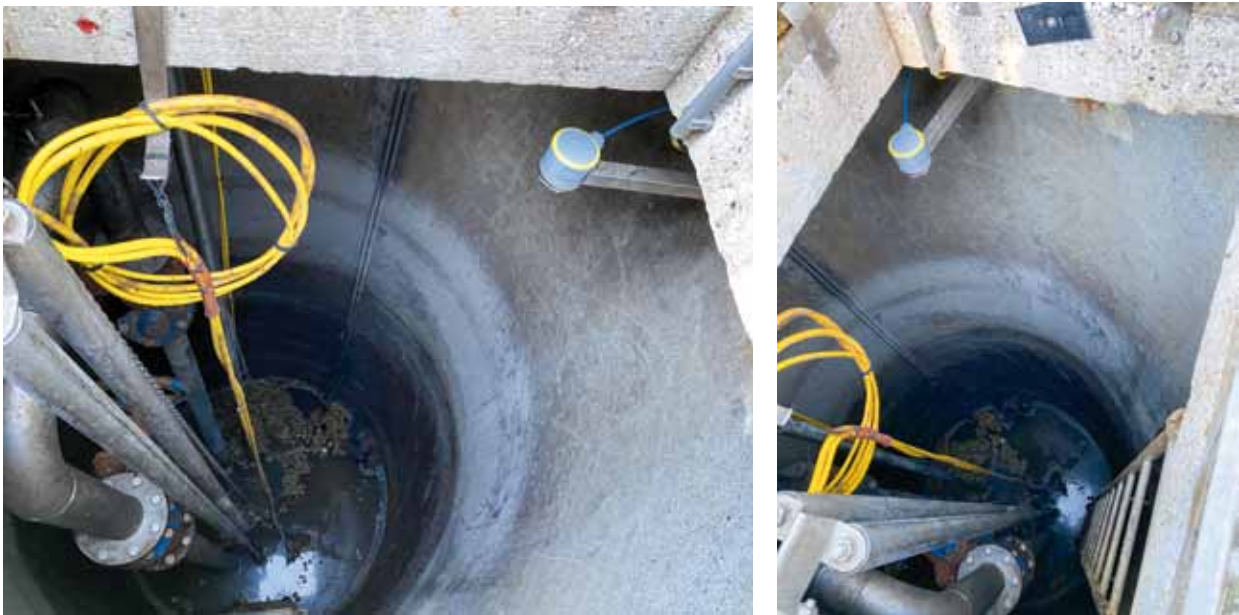
Pozo de bombeo de Buch, en el que puede apreciarse el sensor con tecnología radar de 80 GHz de Vega.
