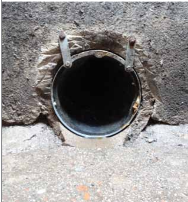
Figura 7. Válvula instalaada sin necesidad de obra.
