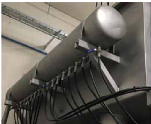
FIGURA 5. Detalle del sistema de presurización y recogida de sólidos.
