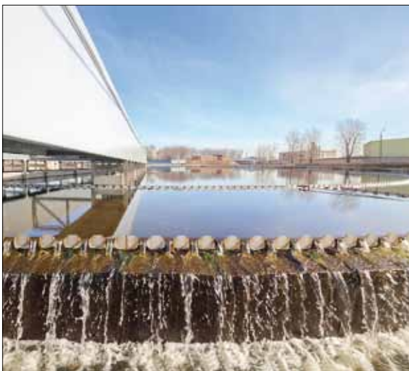
El proceso de aireación en una EDAR, que implica la ventilación en los tanques, es uno de los mayores consumidores energéticos de toda la planta.
