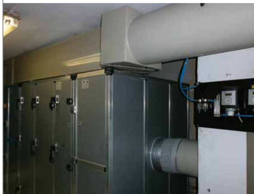
Figura 9. Nuevo sistema de desodorización.
