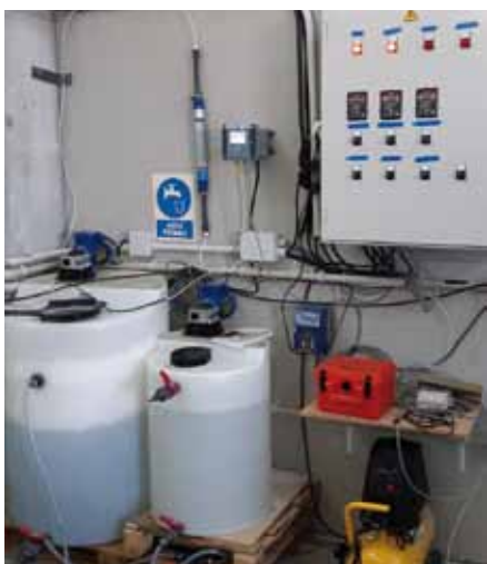
FIGURA 2. Vista general de la planta piloto.
