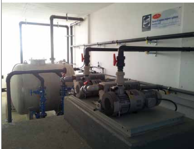
Figura 4. Estación de vacío.
