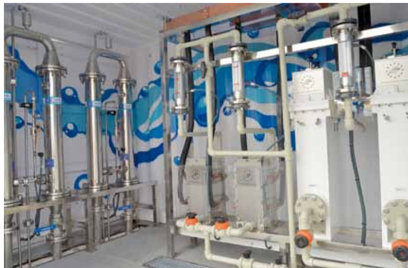
FIGURA 2. Interior contenedor. Tratamiento por membranas y electroquímico.
