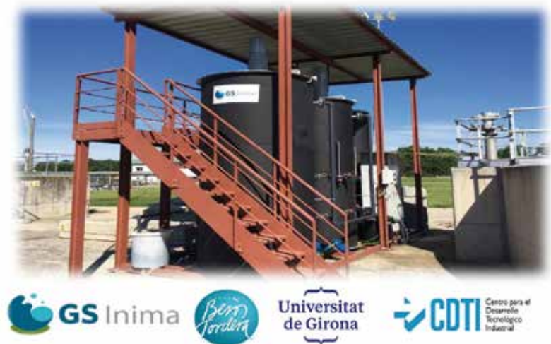
FIGURA 4. Planta piloto en la EDAR de Montornès, Consorci Besòs-Tordera.
