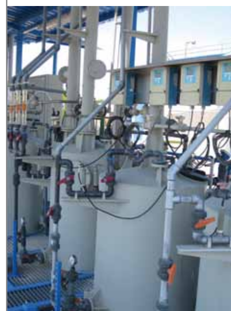
Figura 1. Vista parcial de la planta piloto de limpieza de biogás.
