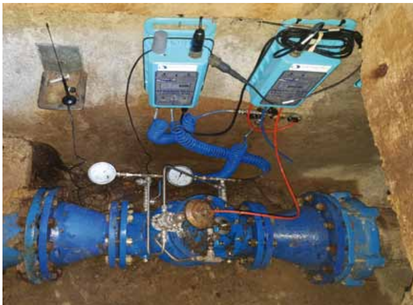
FIGURA 9. Instalación típica de reductora de presión con sistema de control dinámico.
