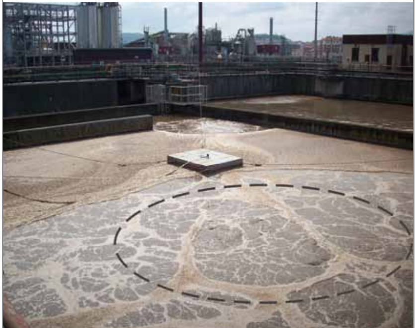
Figura 6. Fotografía del borboteo producido por una fuga de aire en el reactor O_1 de la línea nº 6.
