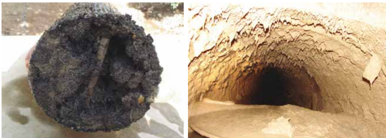
FIGURA 2. Crecimiento de biofouling en infraestructuras de riego de la CRVIG (cazapiedras a la izquierda y tubería a la derecha).
