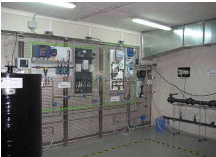
FIGURA 8. Plataforma de Sensores con los sensores de cloro a validar instalados. Fuente: Cetaqua.
