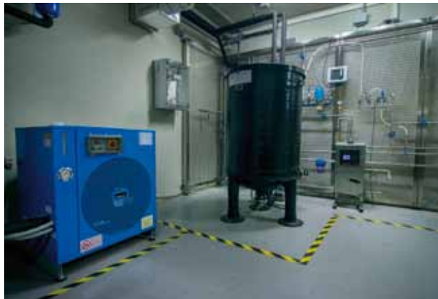
FIGURA 5. Depósito de 400 L y enfriadora para el control de temperatura. Fuente: Cetaqua.
