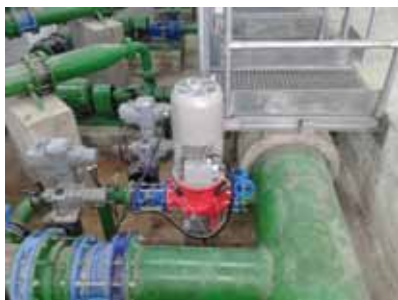
FIGURA 9. Microturbina instalada en La Coma.
