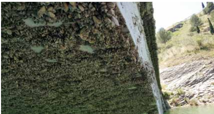
FIGURA 1. Vista de la parte inferior de un puente en el Embalse de Iznájar (Córdoba) afectado por el mejillón cebra.
