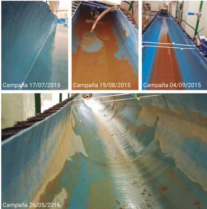
FIGURA 11. Canal Dumo. Secuencia fotográfica de la evolución del interior del canal en diferentes campañas. La campaña del 26/05/2016 corresponde a la revisión del canal Dumo cinco meses después de la finalización del ensayo.
